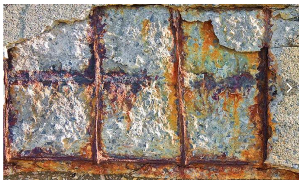
Рисунок 1 – Коррозия железобетонных конструкций
