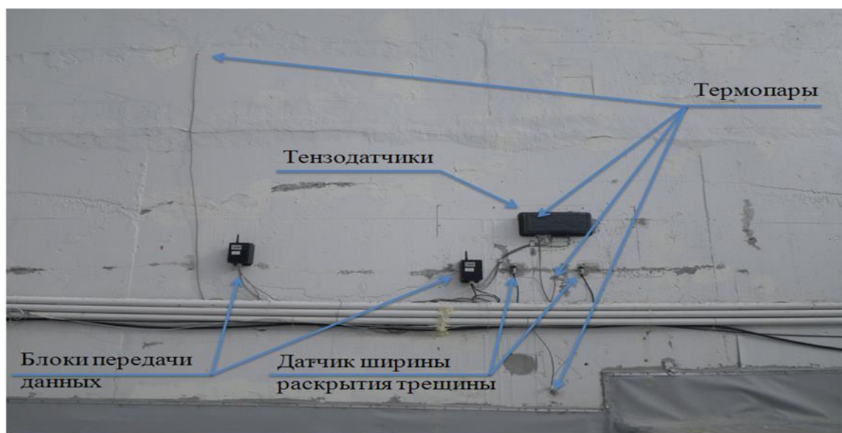
Рис. 18. Общий вид системы контроля и диагностики состояния контейнмента
