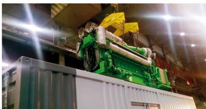
Рис. 2. Газовая теплоэлектростанция ООО «ПитерЭнергоМаш»
