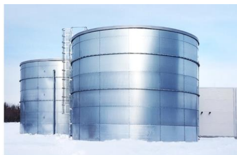
Пожарные резервуары 2х750 м 3 . Самарская область, г. Чапаевск [7]
