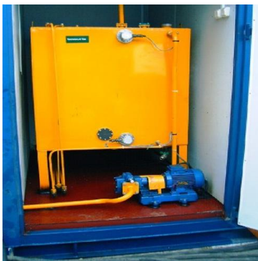
Рис. 2. Резервный топливный бак с топливоподкачным насосом, установленный в блок-контейнере
