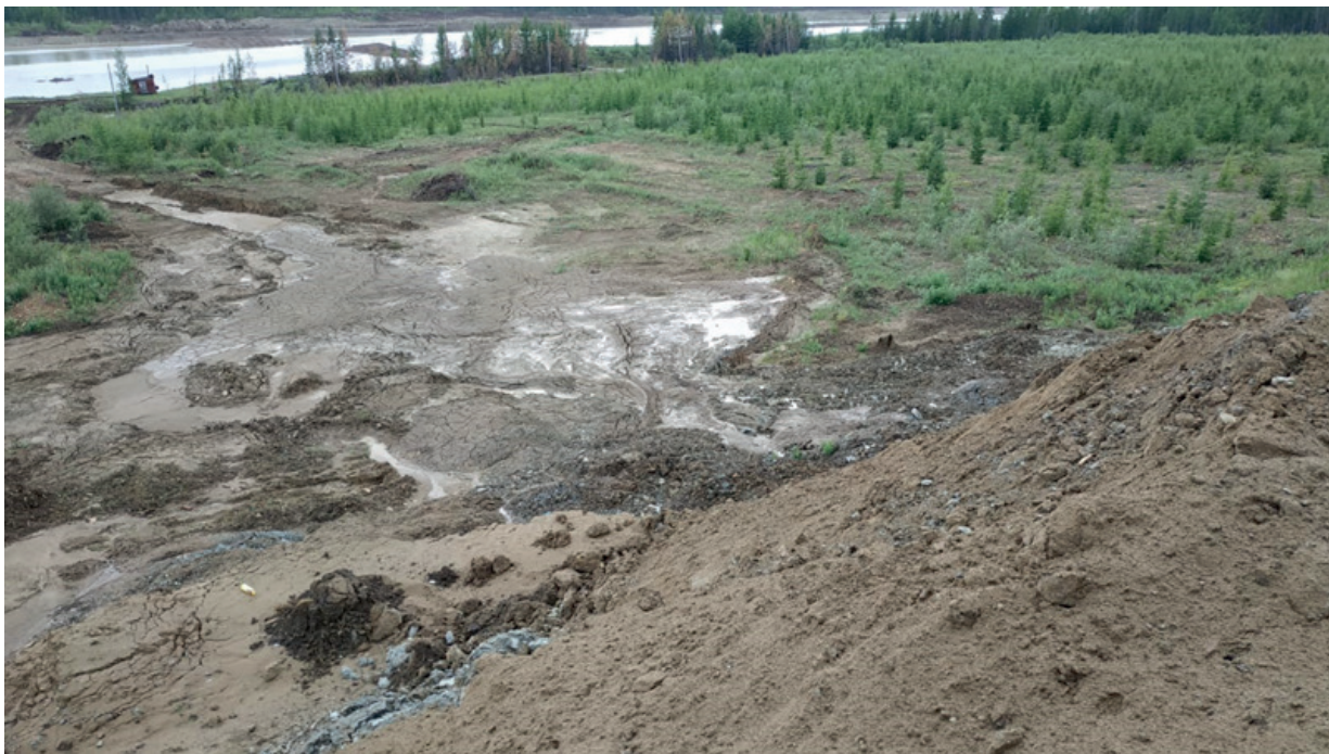
Рисунок 5. Выход фильтрата техногенных вод на ПК130 профиля № 2
