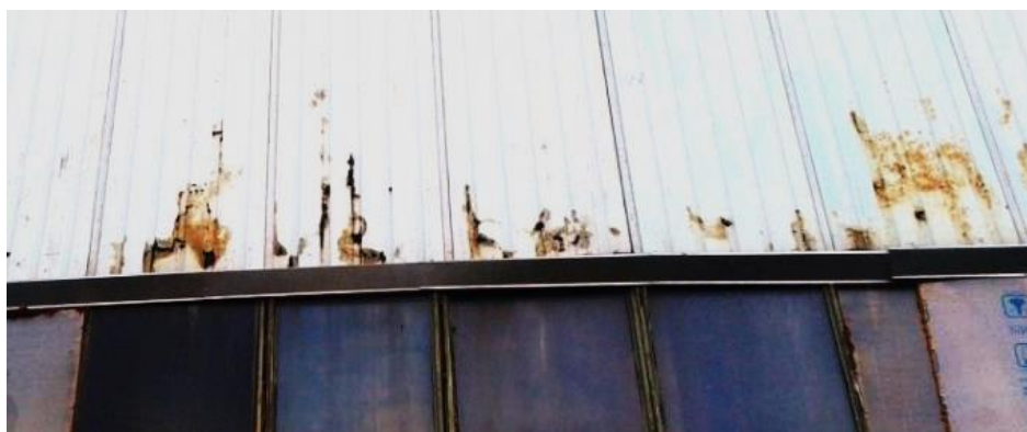
Рис. 1. Ржавчина на стеновых панелях до замены
