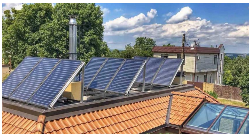
Солнечный коллектор на крыше здания
